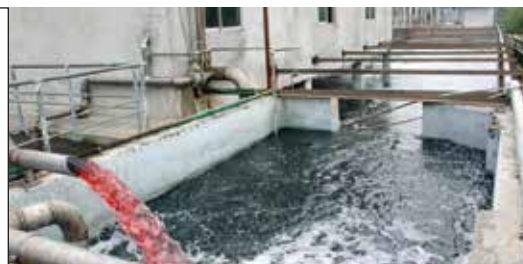
Effluent Treatment Plant (ETP)
